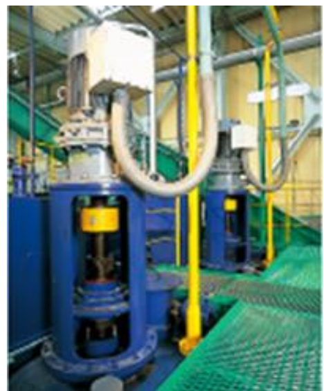
予備処理混練槽
